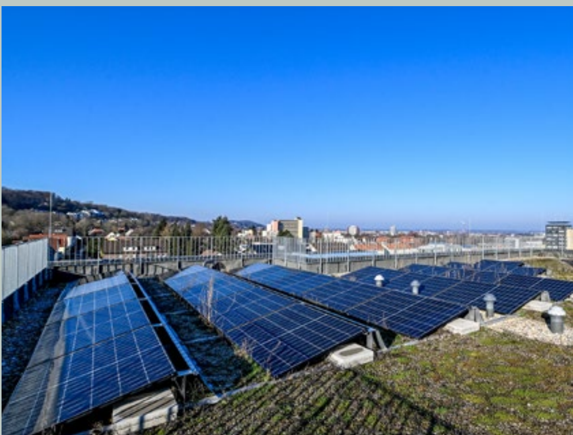
Die Dachbegrünung und Photovoltaikanlage auf dem BGW-Gebäude am Lipper Hellweg 70 („Young Urban Living“)
